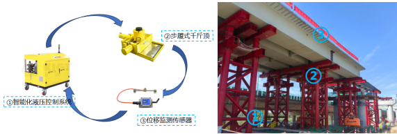
图6 钢箱梁智能监测系统
