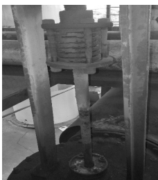
阀杆腐蚀磨损变细
