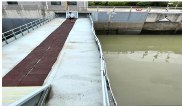
图3 船舶碰撞闸后闸门变形图片
