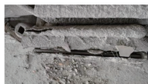
图七 断芯 开裂
