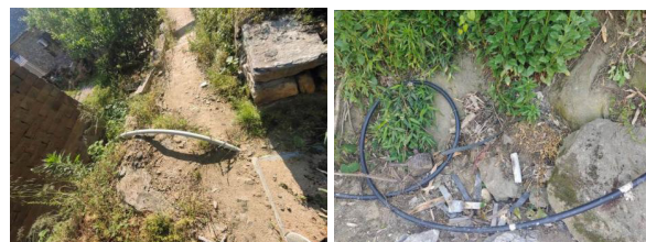
图6 破损的小路和突起的水管
