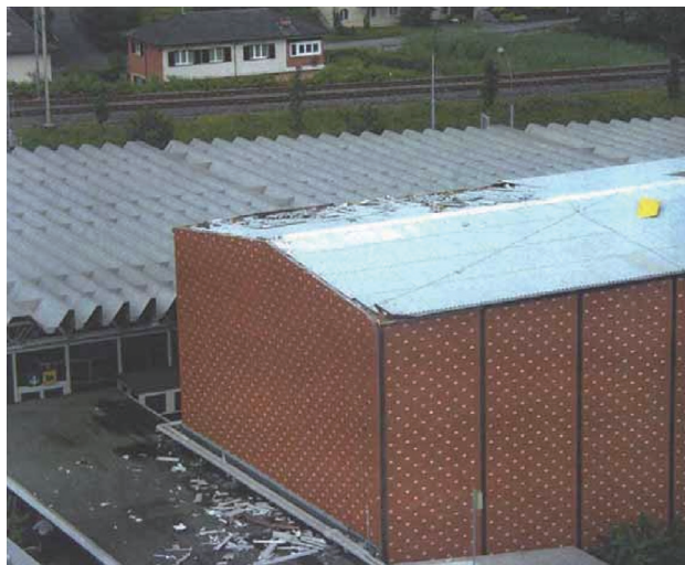
> 图5建筑物屋顶损坏 [3]
