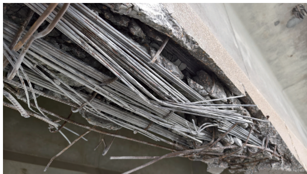
> 图1.2 24-5#T梁损伤近照
